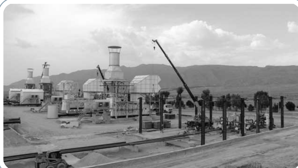
ایستگاه تقویت فشار گاز جهرم
